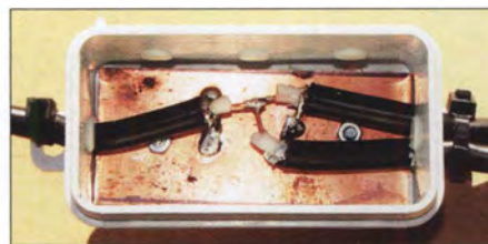
Bild 8: Installationsdose zur Zusammenschaltung der Koaxialkabel Fotos: DK7ZB
