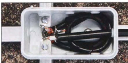
Bild 6: Neue Anschlussdose mit dem Halbwellenbalun
